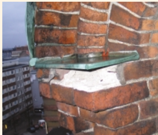
Vesi on syönyt laastin ja tiili on irronnut. Kuva: IKJ Rakennus Oy
